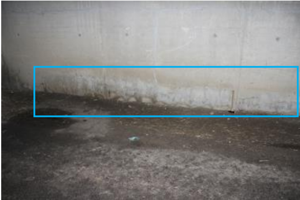
Foto 9: Hohlstelle entlang gesamter WL-Breite
